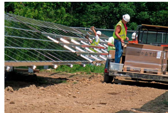
Parc photovoltaïque de Hackettstown - USA - 21,5 MWc.
