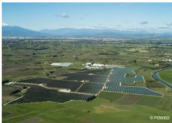
Parc solaire de Torreilles - Pyrénées-Orientales.
