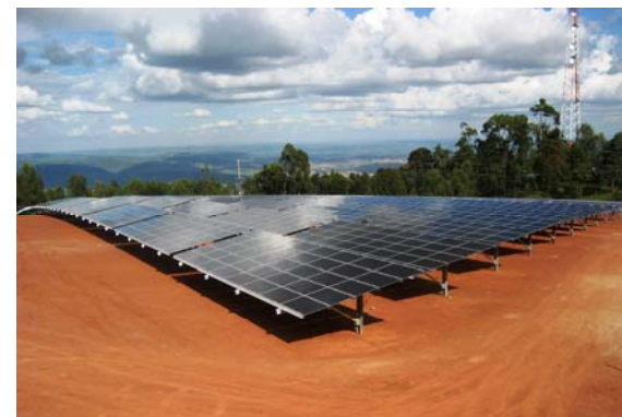
Parc photovoltaïque de Kigali - Rwanda - 0,25 MWc.
